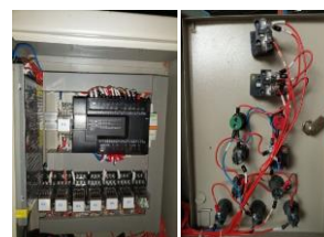
Gambar 10. Penampang fisis kotak panel dan terminal-terminal penghubung komponen-komponen
